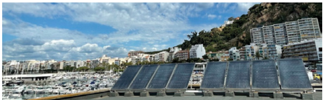
Plaques fotovoltaïques en el Port
