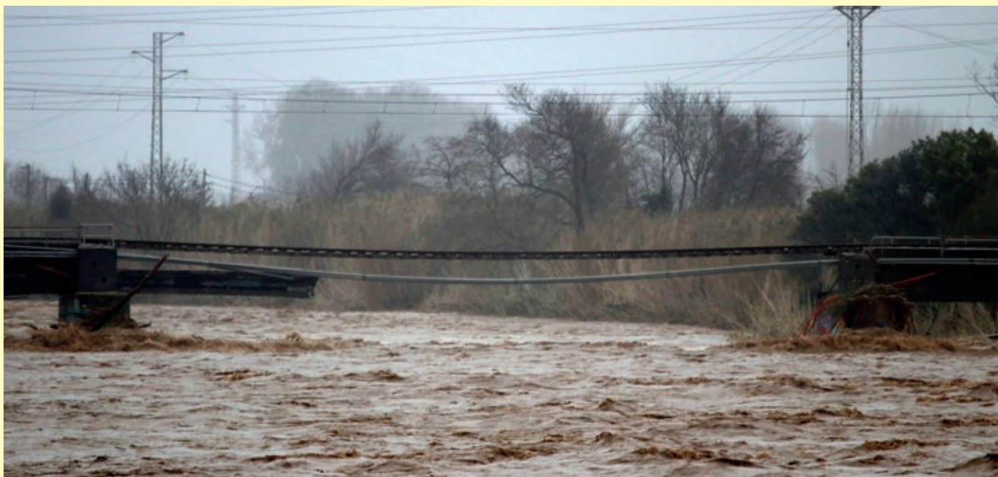
Pont del tren fet malbé, entre Blanes i Malgrat de Mar, que ha deixat sense servei les línies R1 i RG1 de Rodalies.
